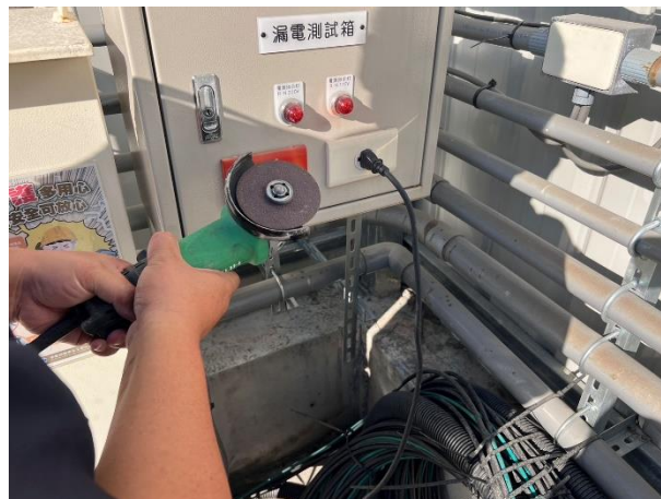
電動手工具漏電測試
