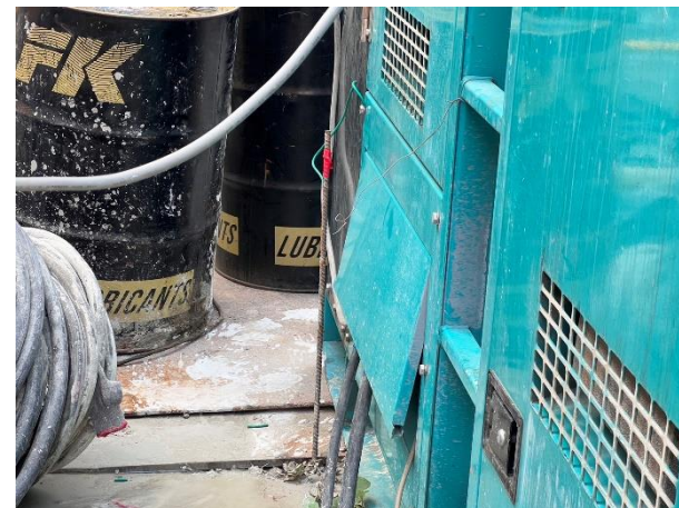
發電機外殼接地避免漏電發生感電危害
