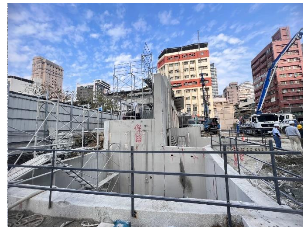
開口部安全護欄
